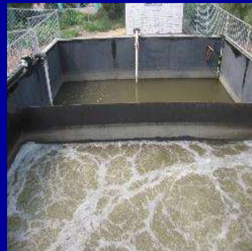
顺义安乐村污水处理站
