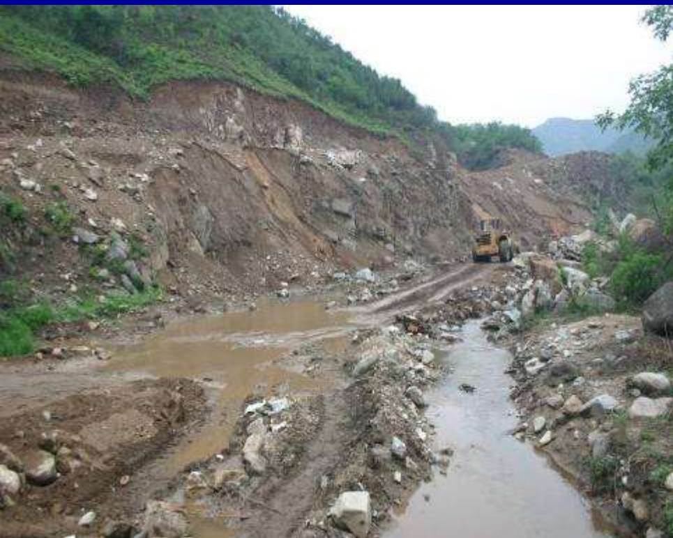
修路造成的水土流失
