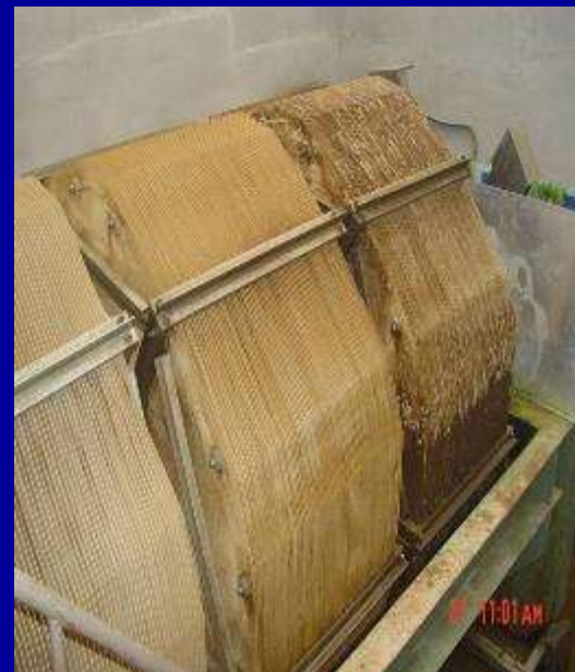
丰台北宫森林公园污水处理站
