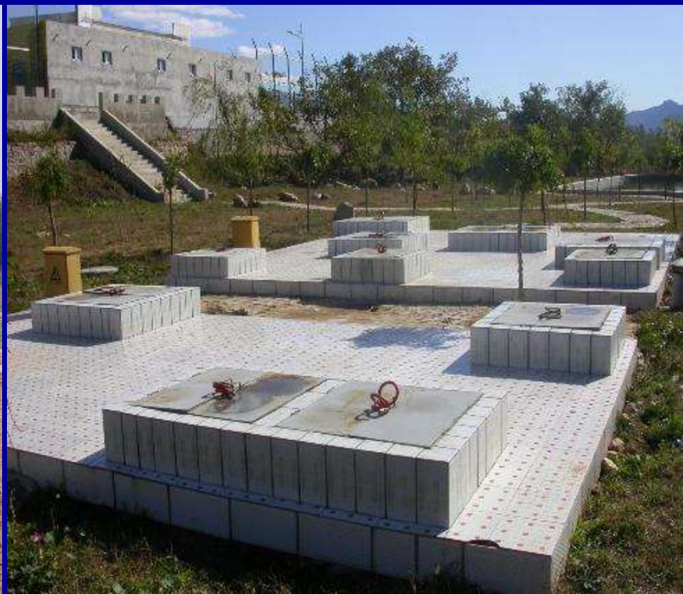
平谷黄松峪小流域污水处理站 35
