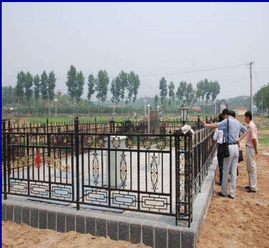
密云黄土坎小流域小型污水处理站
