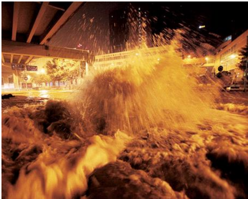
2010年，北京国贸桥通信施工挖断供水和燃气管道
